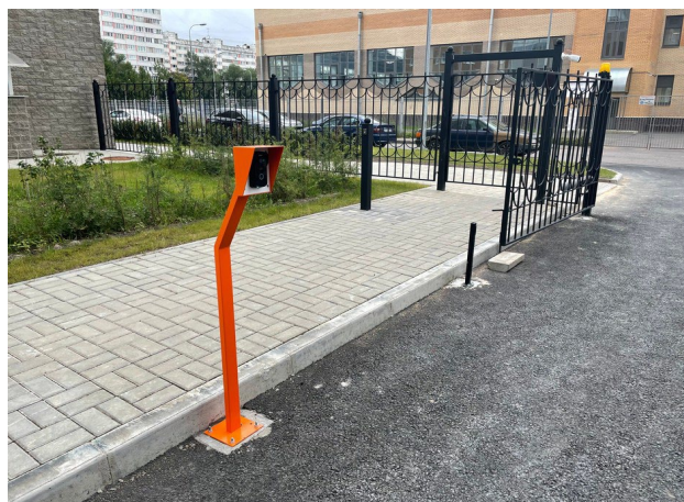
Система контроля и управления доступом
