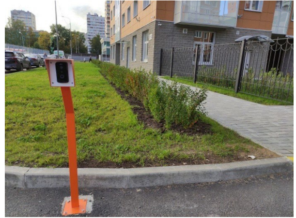
Система контроля и управления доступом
