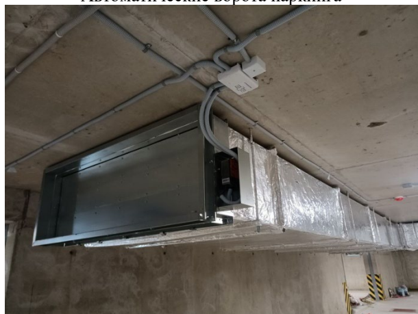
Система дымоудаления в паркинге
