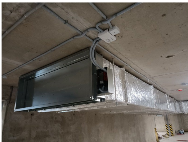
Система дымоудаления в паркинге
