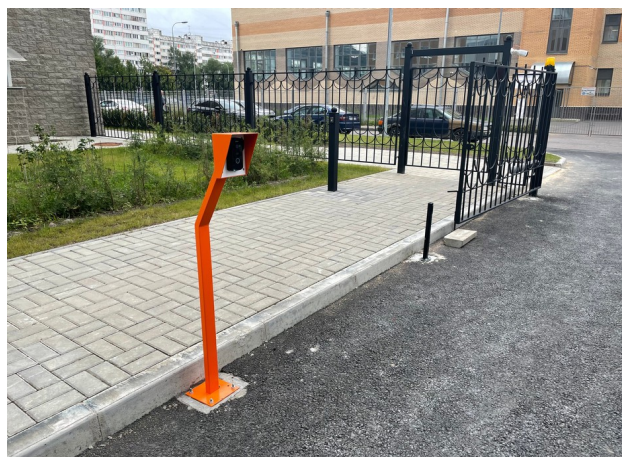
Система контроля и управления доступом
