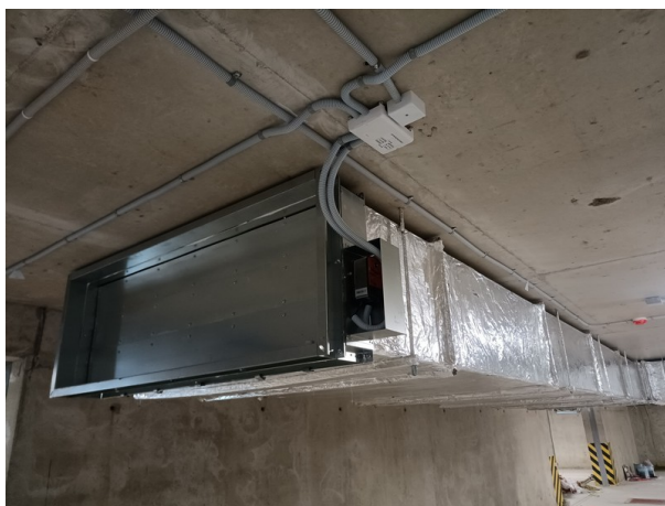
Система дымоудаления в паркинге
